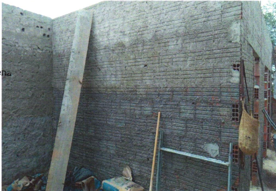
FOTO 10 - CHAPISCO APLICADO EM ALVENARIA (COM PRESENÇA DE VÃOS) E ESTRUTURAS DE CONCRETO DE FACHADA, COM EQUIPAMENTO DE PROJEÇÃO ARGAMASSA TRAÇO 1:3 COM PREPARO EM BETONEIRA 400 L. AF_06/2014
